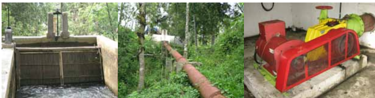
Gambar 2. Pemanfaatan Aliran Air dari Hutan Lindung untuk Pembangkit Listrik tenaga Mikro Hidro
